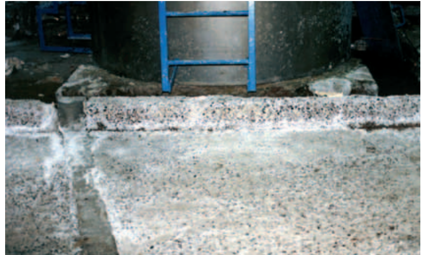
Invallningar i betong utsätts många gånger för aggressiva kemikalier som förstör betongen.
