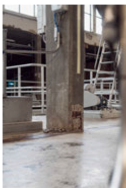
Betongskadorna syns på många ställen.
